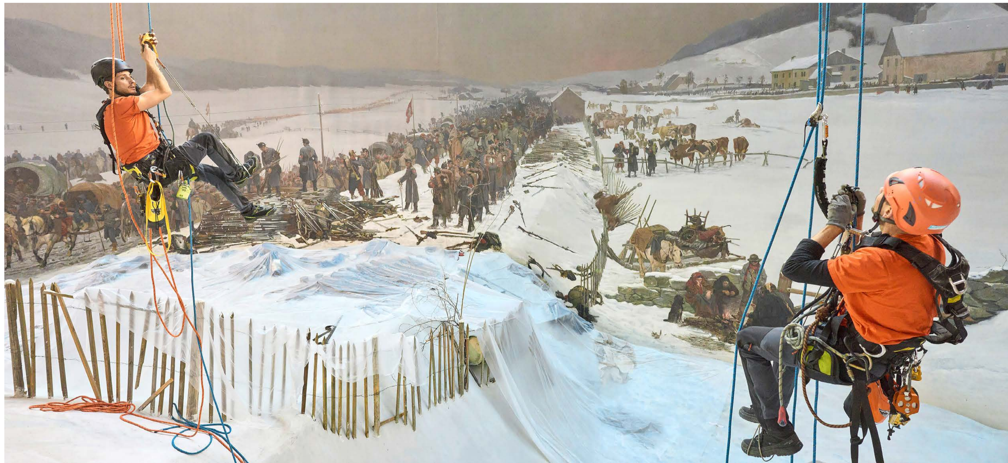
Spektakuläre Montagearbeit in luftiger Höhe: Zum Schutz der dreidimensionalen Faux terrains unter der Leinwand ersetzen Industriekletterer die Gerüste.
